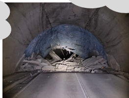
中屋トンネル工区 被災状況(2024.1)
